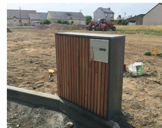
Modèle du coffret installé par l'aménageur
